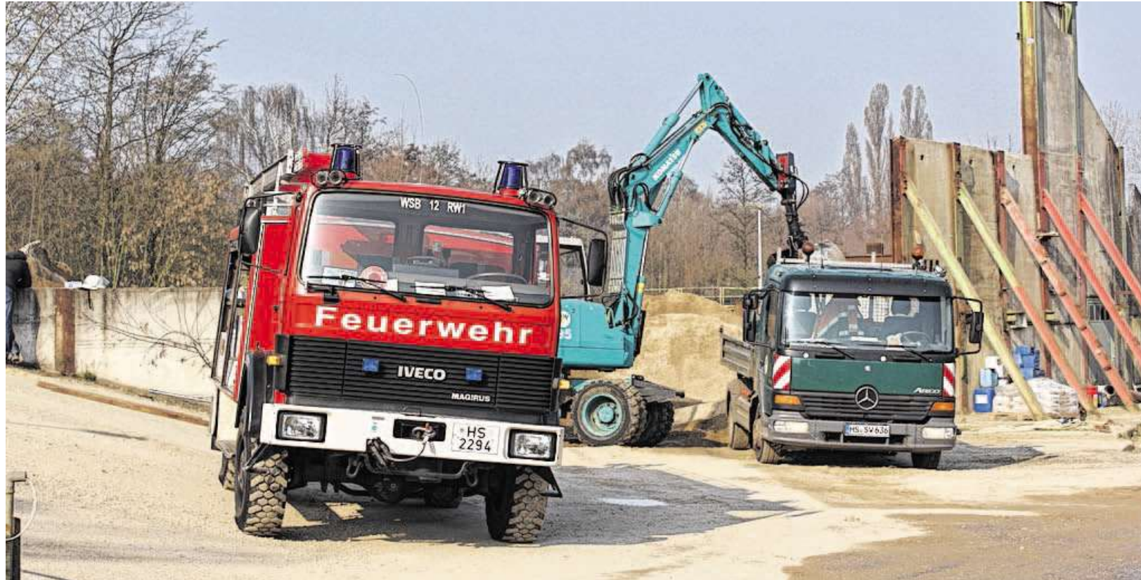
Dass die Feuerwehr den ausgelaufenen Kraftstoff abnahm, reichte noch nicht aus. Der Stadtbetrieb und eine beauftragte Firma baggerten unter Aufsicht der unteren Wasserbehörde das Erdreich in größerem Umfang ab. Fotos: Krockner
